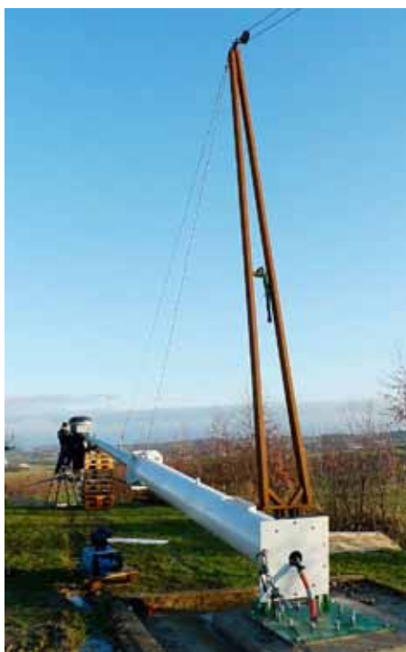
6 kW husstandsmølle lægges ned ved service...
