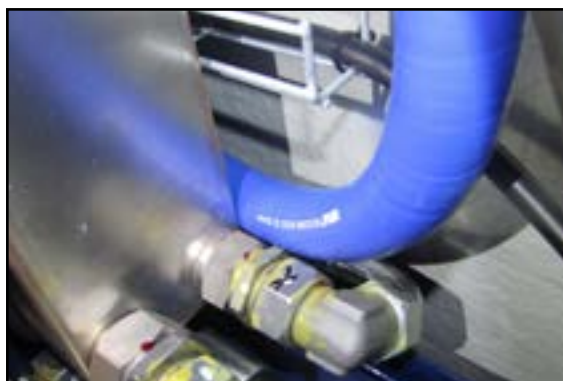
Når slanger og kabler ikke er ordentlig fastgjort, bliver de slidt i nærheden af skarpe genstande.
