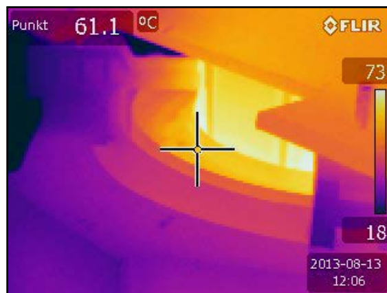
Termografi foto af lavspændingspole på tørtransformer.
