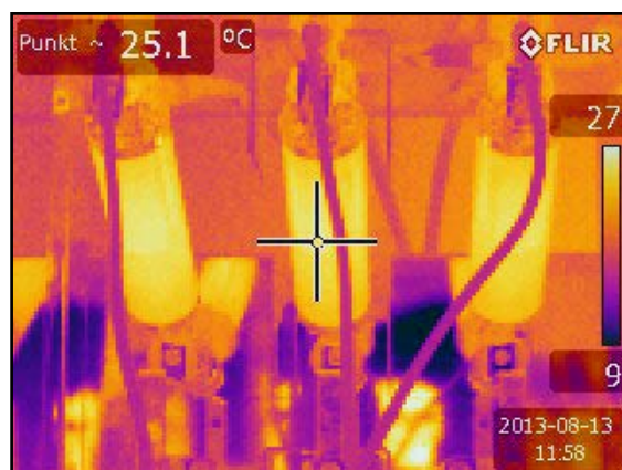
Termografi foto af sikringer
