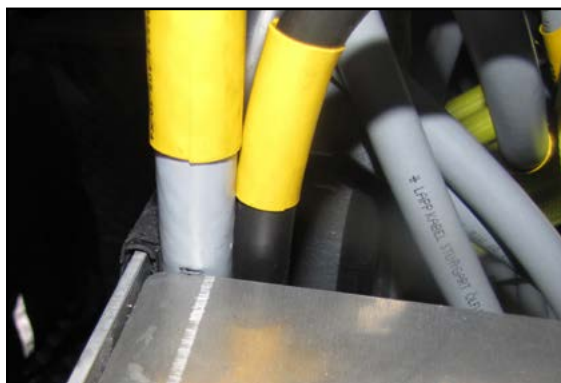
Kabler der slides på skarpe kanter.
