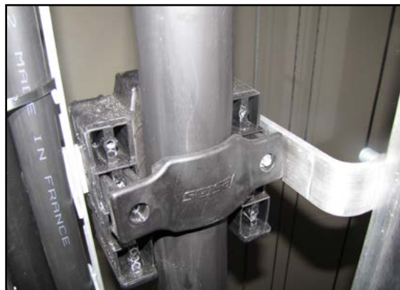
Manglende fastgørelse af kabel i tårn.
