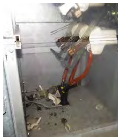
Havari af højspændingsbryder.
