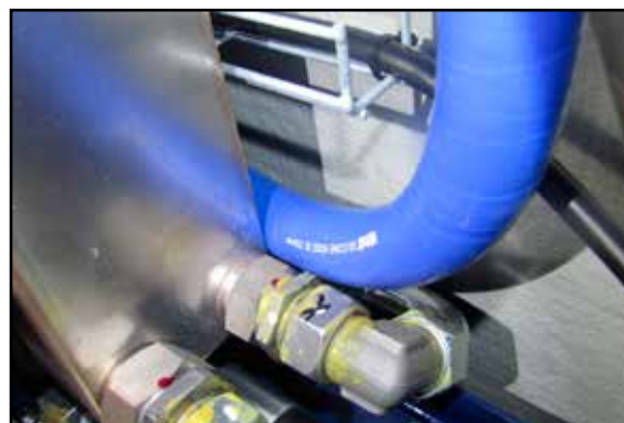
Når slanger og kabler ikke er ordentlig fastgjort, bliver de slidt i nærheden af skarpe genstande.
