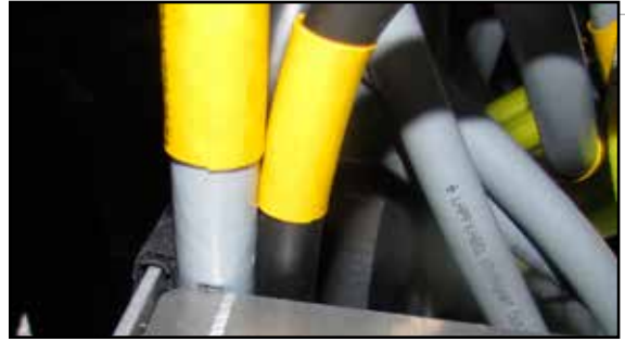
Et kabel er slidt af en skarp kant på en plade.
